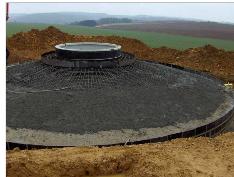
Figure 8 : Exemple de ferrailage en radier pour une éolienne (chantier en cours, source Vestas)
